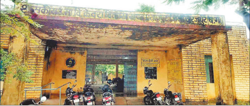
जर्जर स्कूल भवन।
